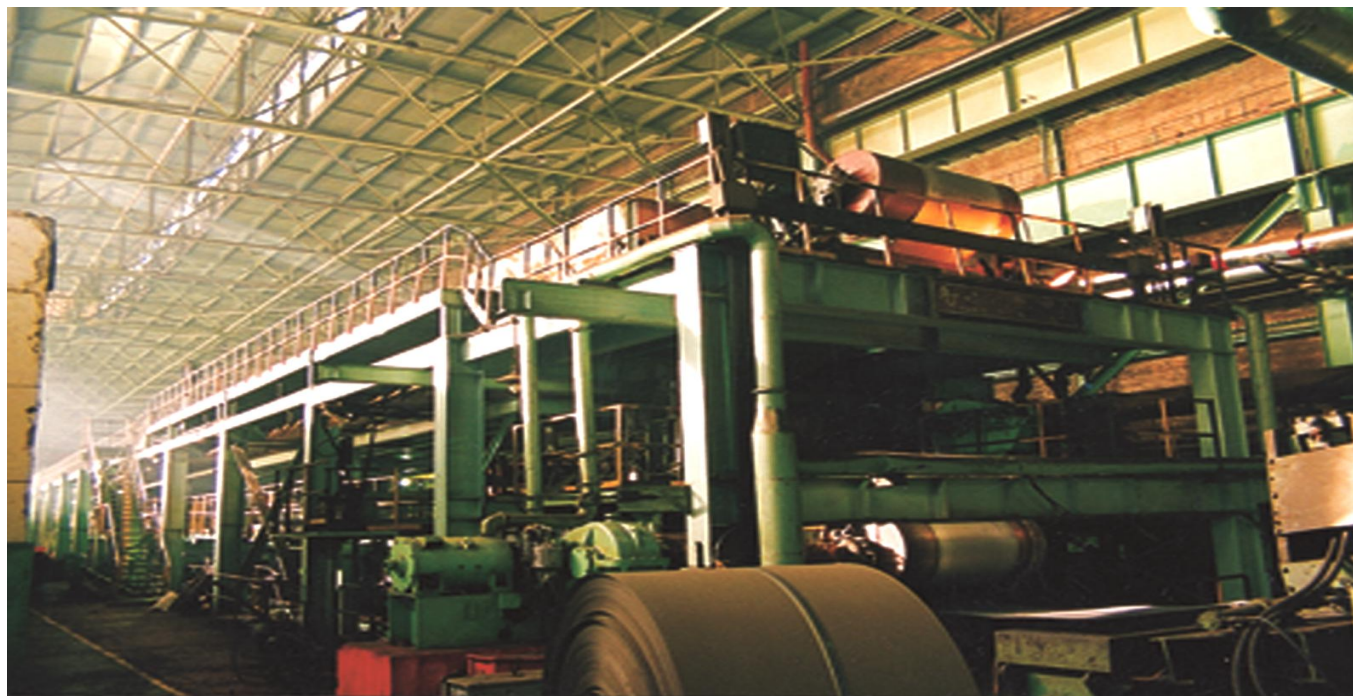
冷轧酸洗机组 Cold rolling pickling unit
