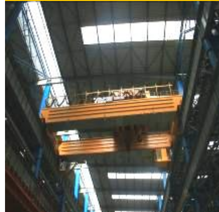
280t crane 280吨铸造吊车
